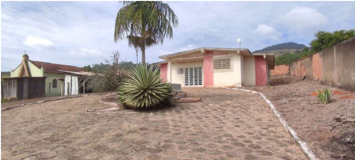
Imagem 01: Entrada com bloquete e meio fio que receberão pintura, muro lateral receberá chapisco e reboco.
